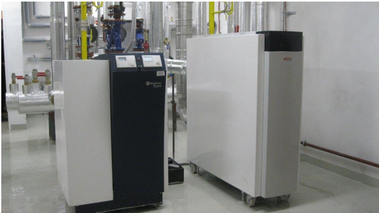
Závodiště Velká Chuchle, Praha 5 - rekonstrukce plynové kotelny/výstavba nového zdroje, financováno z investičních prostředků společnosti Prometheus, a.s., velikost zdroje 464 kW, realizace říjen 2017
