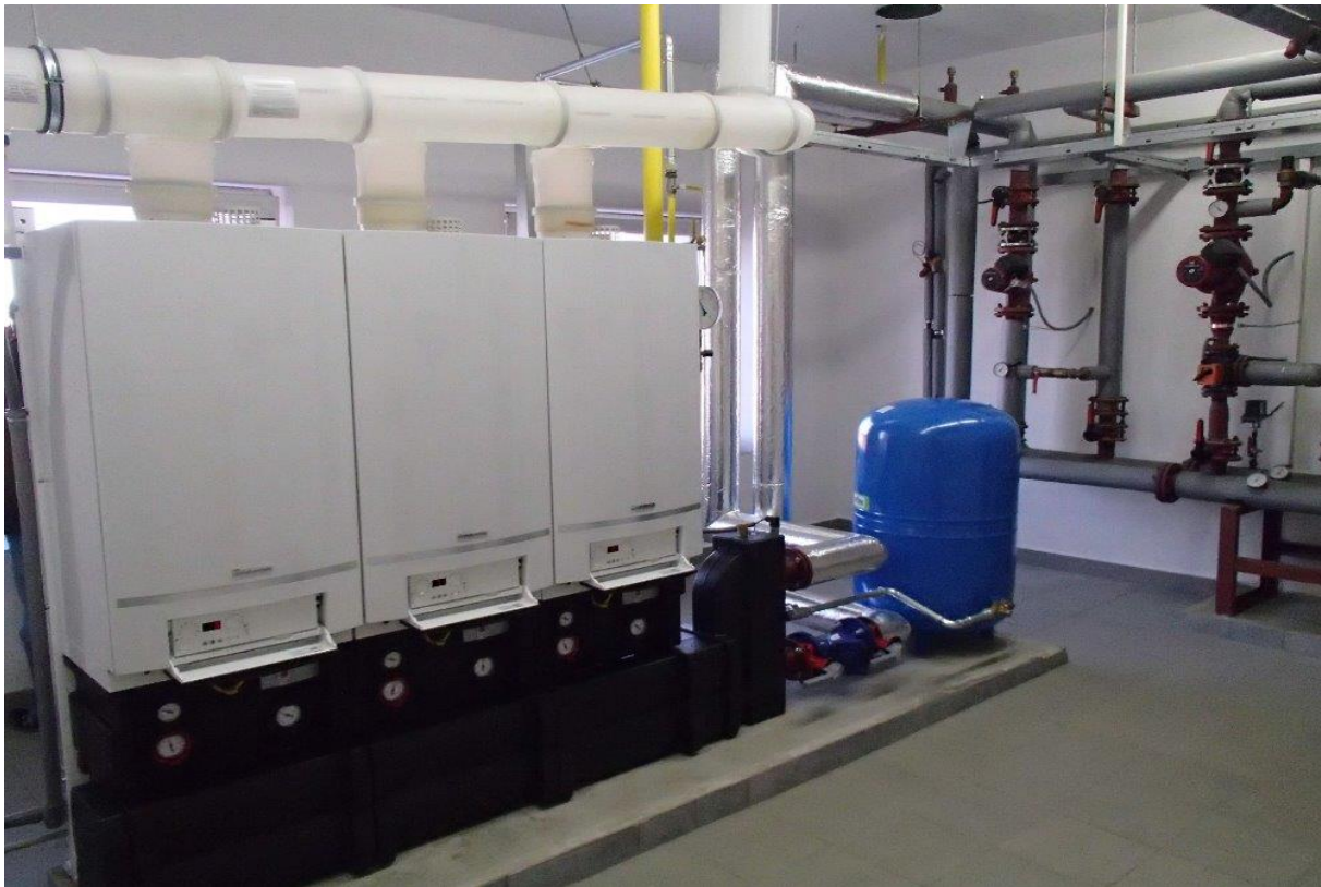
Společenství vlastníků Srbínská, Praha 10 - rekonstrukce plynové kotelny/výstavba nového zdroje, financováno z investičních prostředků společnosti Prometheus, a.s., velikost zdroje 300 kW, realizace srpen 2017
